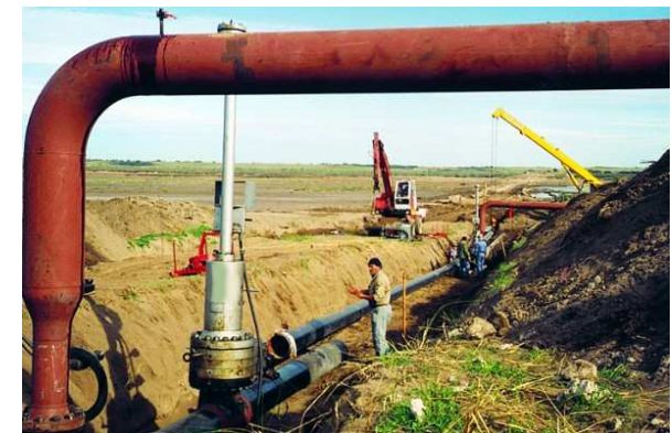
Absperrung DN 350 mit Bypass
